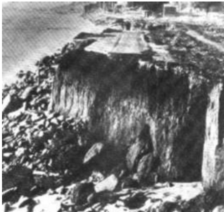
Fig. 9.12. Estrada cortada pela erosão das ondas (EUA)
