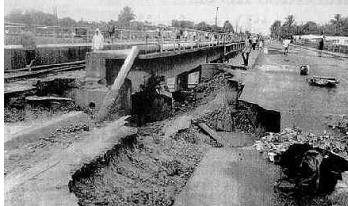
Fig. 5.2. Deslizamento de terras na ponte da Vulcano sobre a Rua da Vala. Março de 2000
